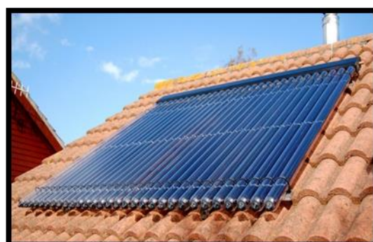
Fig,35: panneau solaire thermique
