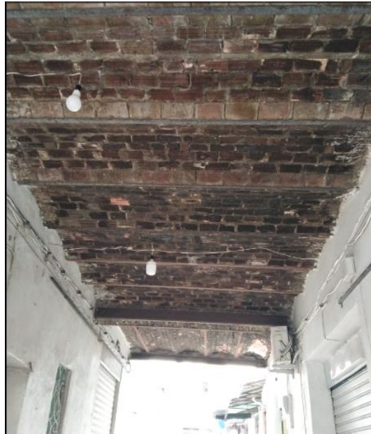
Figure43 : les fissures importantes
