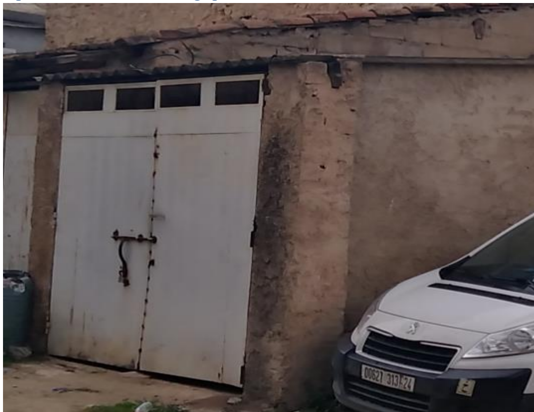
Figure2 : humidité dans la façade
