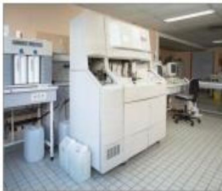
Figure 101 revêtements de sol de laboratoire source : www.laborantin.com
