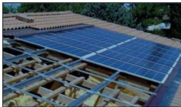
Figure 58: Figure Mode d'intégration du capteur sur une partie d'une toiture en pente Source : Guide régional pour l'intégration architecturale des capteurs solaires
