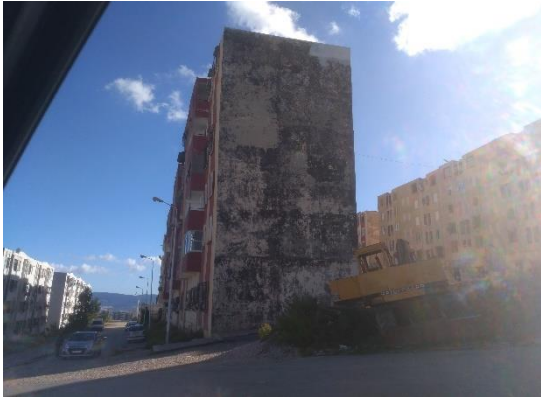
Figure 83 bâtiment en mauvaise état
