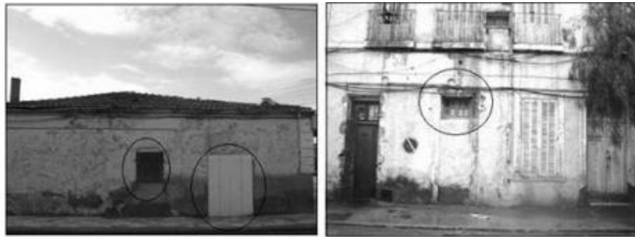
Figure 13 : Obstruction et/ou rajout d'ouvertures
