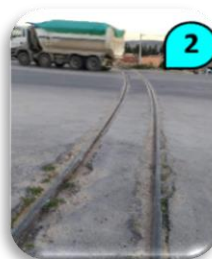
Figure 114 : la rupture de voie, source : prise par l'auteur
