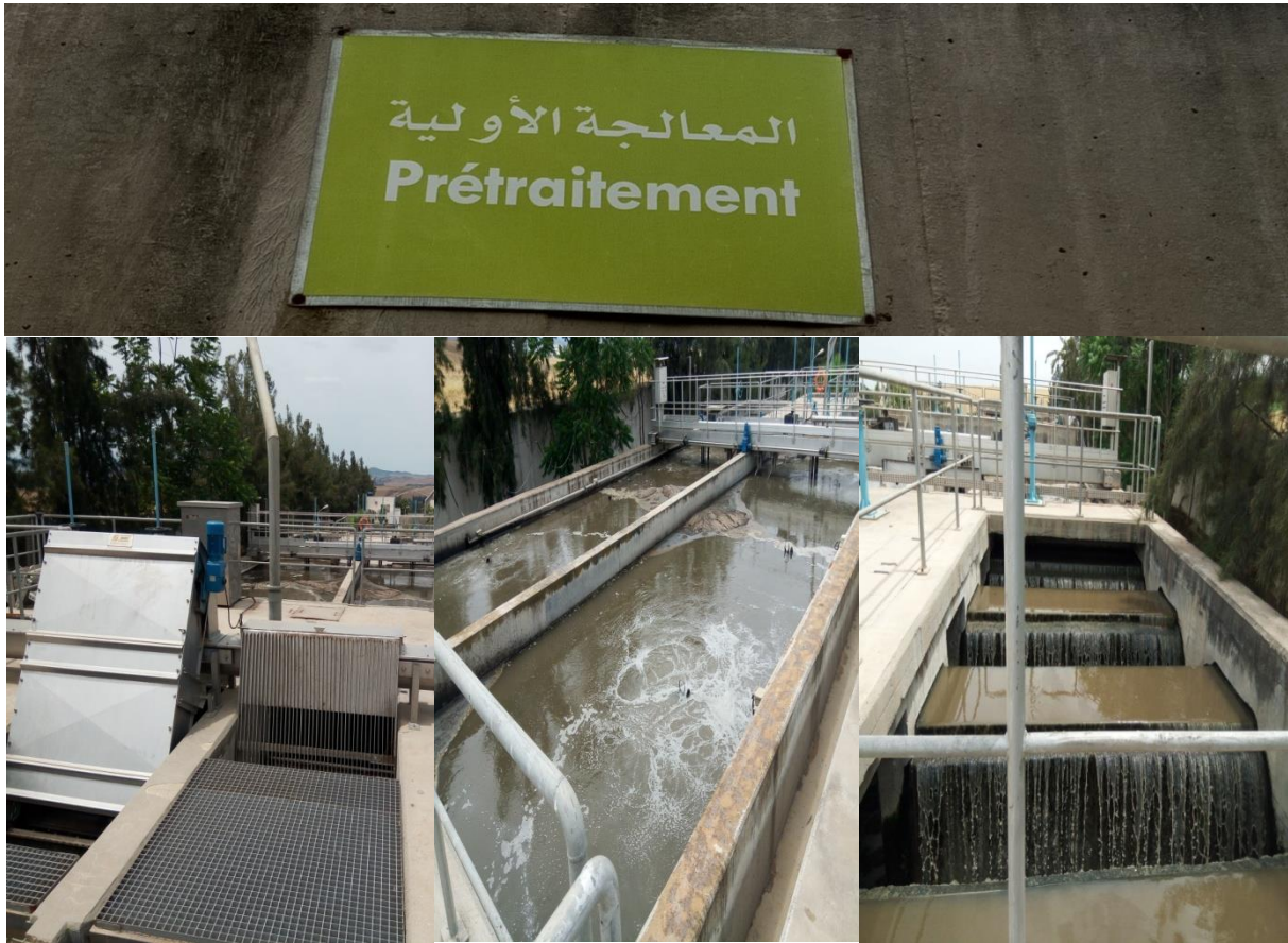
Figure 10: Ouvrage de prétraitement (dégrilleur, déshuilleur et déssableur) (Prise personnelle).
