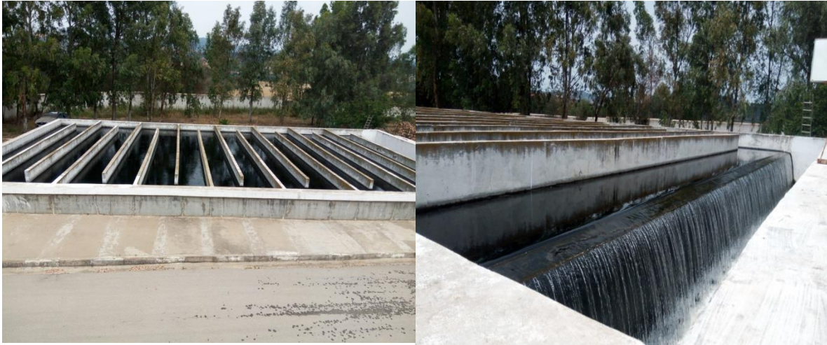
Figure 14 : Bassin désinfection (Prise personnelle).
