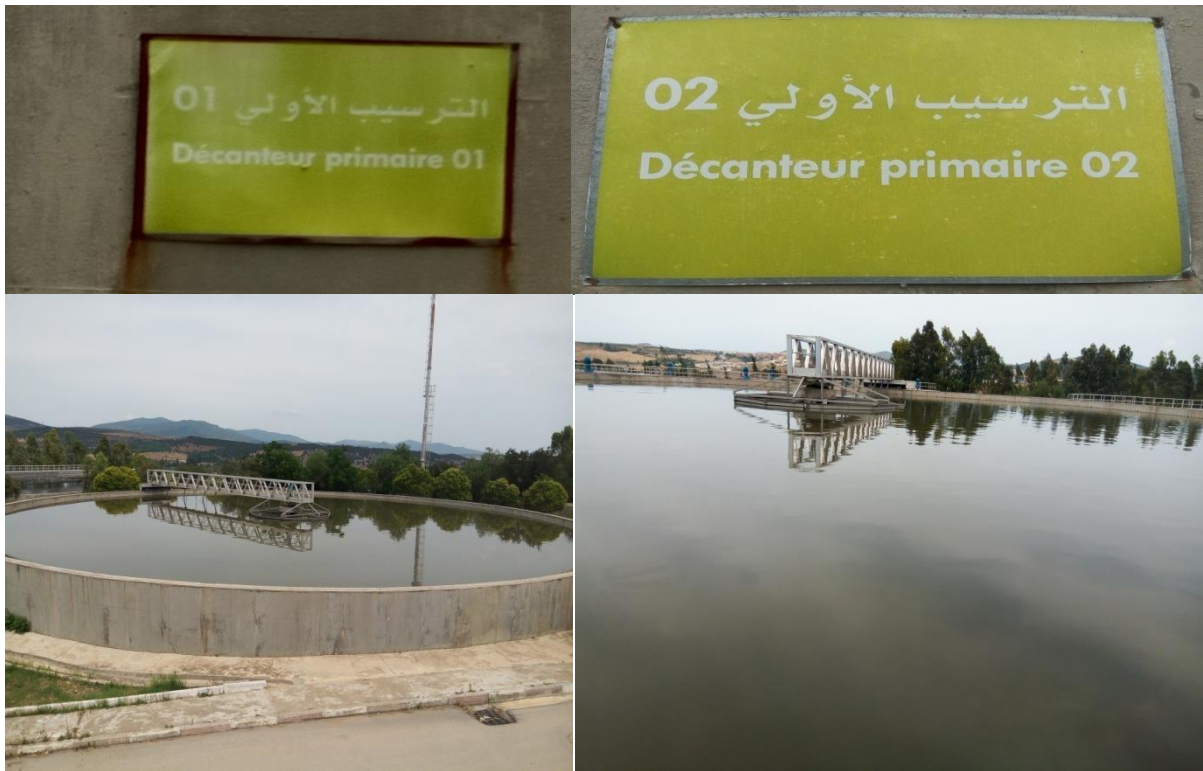
Figure 11 : Les décanteurs primaires (Prise personnelle).
