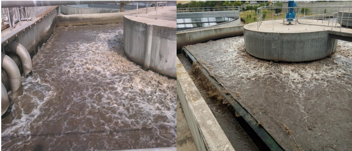
Figure 12 : Bassin d'aération (Prise personnelle).
