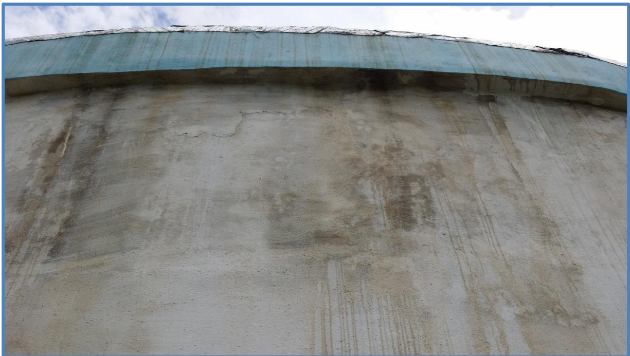
Figure 1 : Des Fissurations au réservoir de Pos SUD
