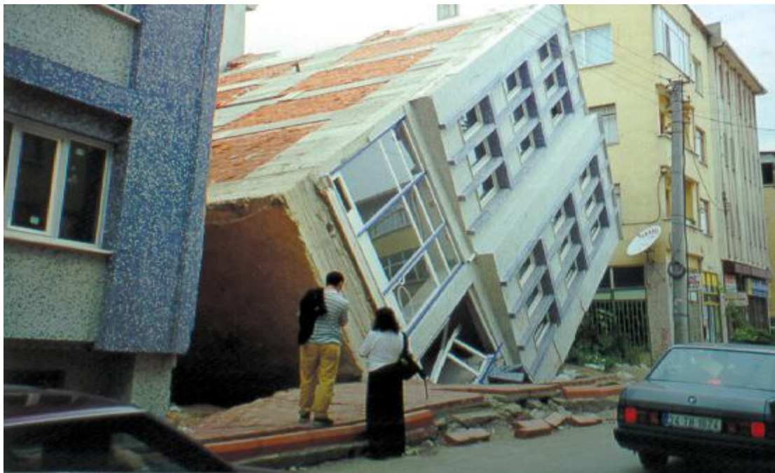
Fig. III.9 Séisme d'Izmit (Turquie) : perte de portance par liquéfaction du sol lors du séisme du 17 août 1999.
