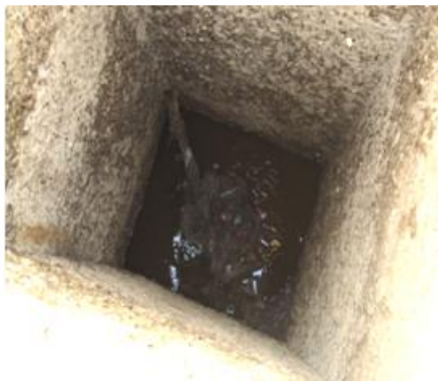
Regard 13 : (accumulation de dépôts)
