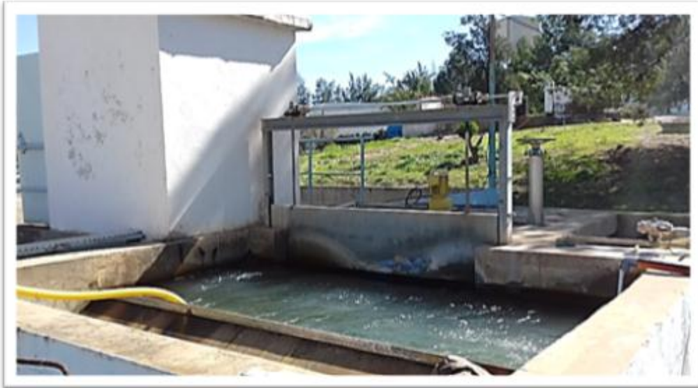
Figure 18. Bassin du pré chloration (Auteur).
