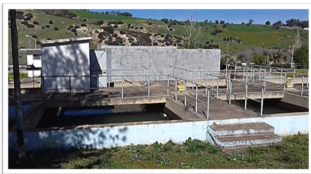
Figure 19. Bassin de coagulation-floculation (Auteur).
