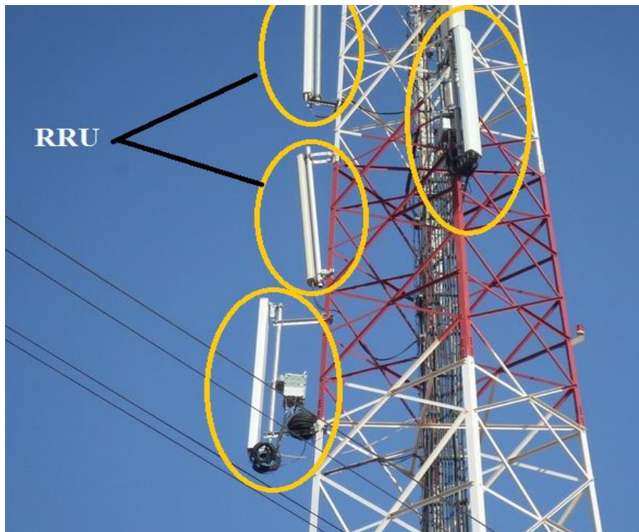
Figure 5.2 : Le pylône principale de Guelma "Maouna".
