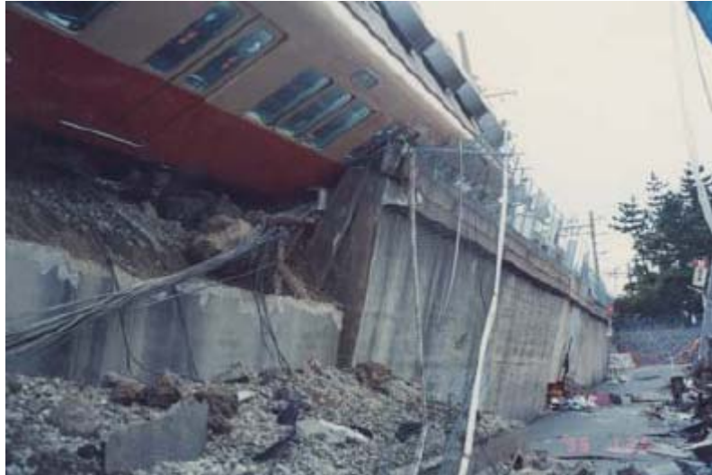
Figure. 0.1 Mur de soutènement sinistré par le séisme de Hyogoken Nanbu (Kobe) 1995.
