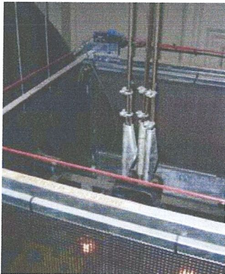
Figure 6 : La cabine suspendue par les câbles.
