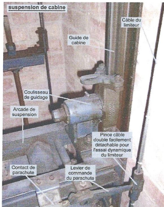
Figure 2 : Suspension de la cabine, on y distingue le guide en forme de T et la gaine (mur en briques)
