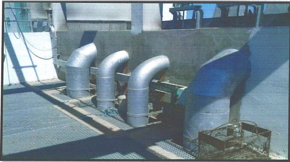
Photo I.3 : Les pompes de relevage
