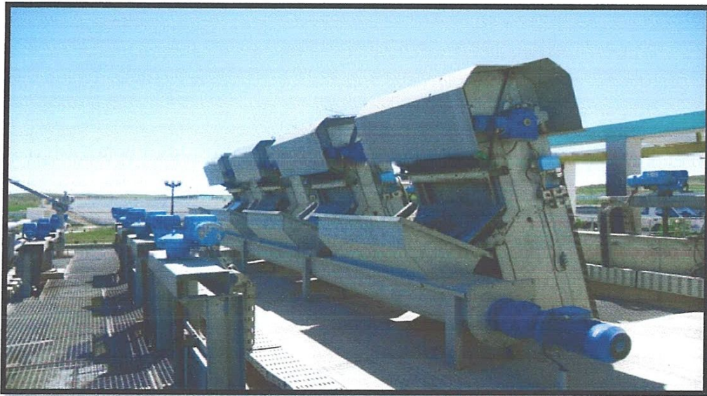
Photo I.4 : Le dégrilleur fin
