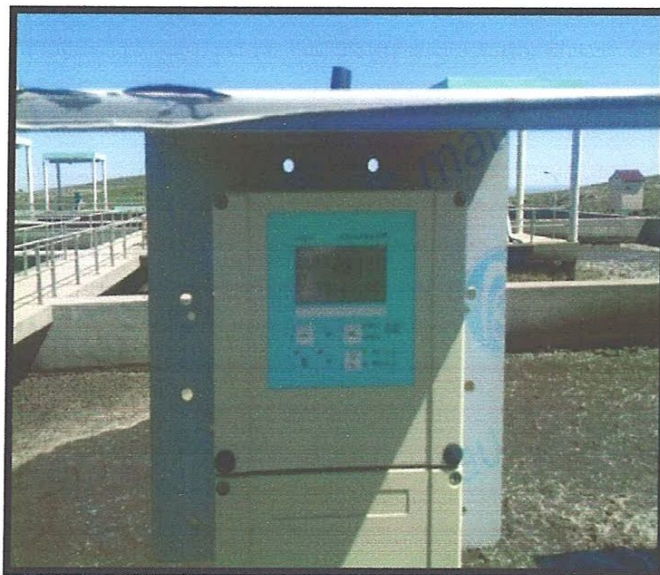
Photo I.9 : L'oxy-mètre de bassin d'aération
