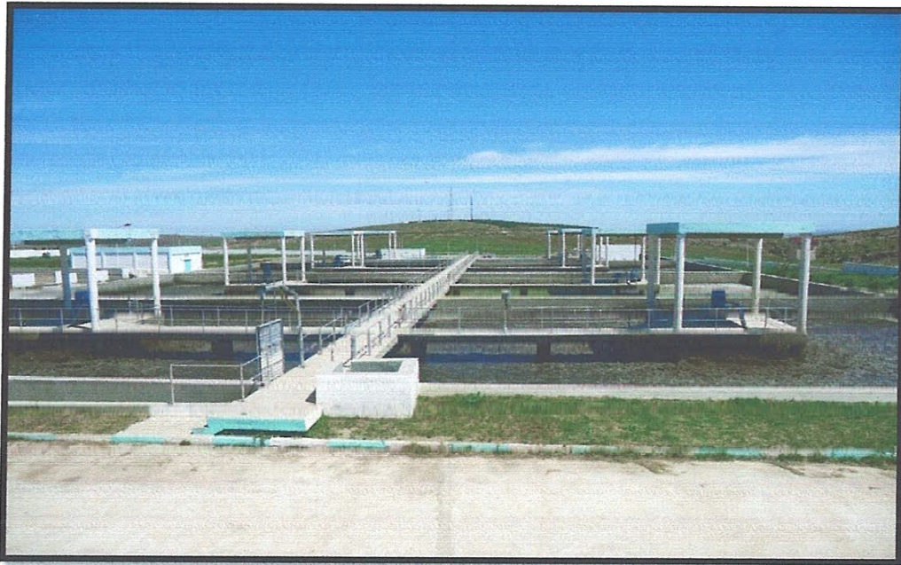
Photo I.8 : Les bassins biologiques (bassins d'aération)
