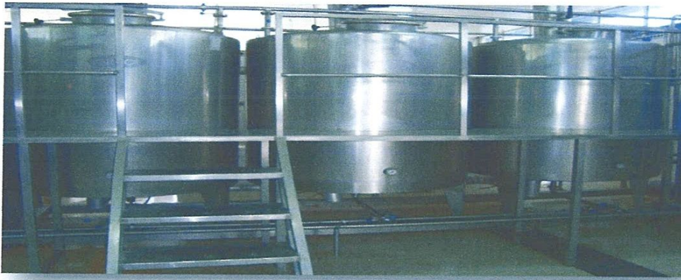
Figure III.7 : les cuves de réception
