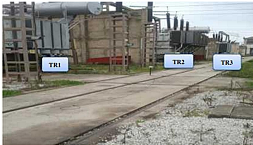
Fig 4.3 : Passage de transformateurs
