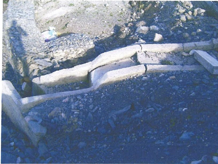
Photo3.6. descente d'eau endommagée
