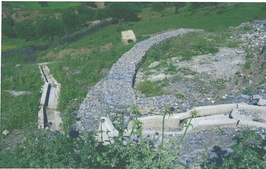
Photo3.3 déformation du sol visible par la déformation des lits de gabion
