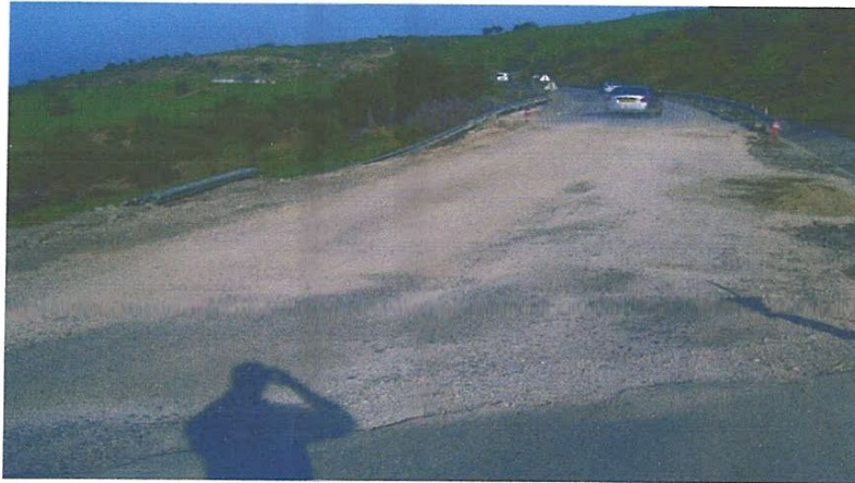
Photo3.1. dégradation de la route
