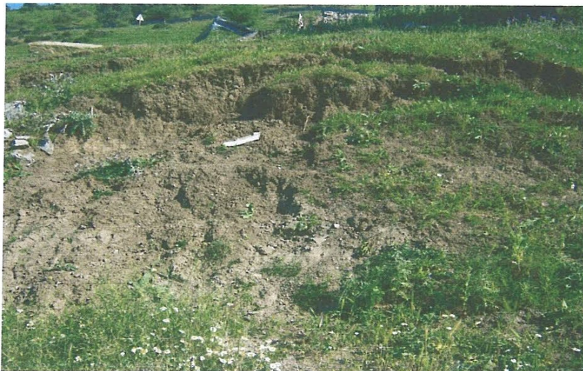
Photo 3.5. Des suppressions dans le corps du talus
