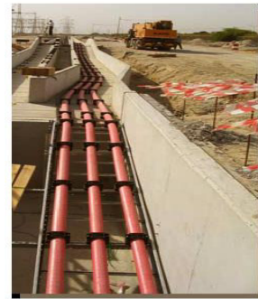
b. Lignes souterraines
