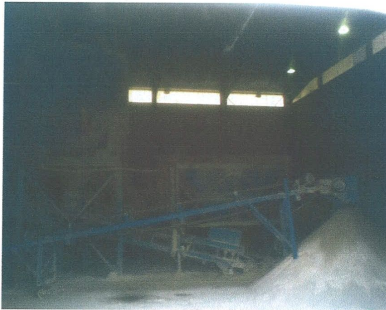
Figure 11: Atelier de Traitement du calcaire et dolomie
