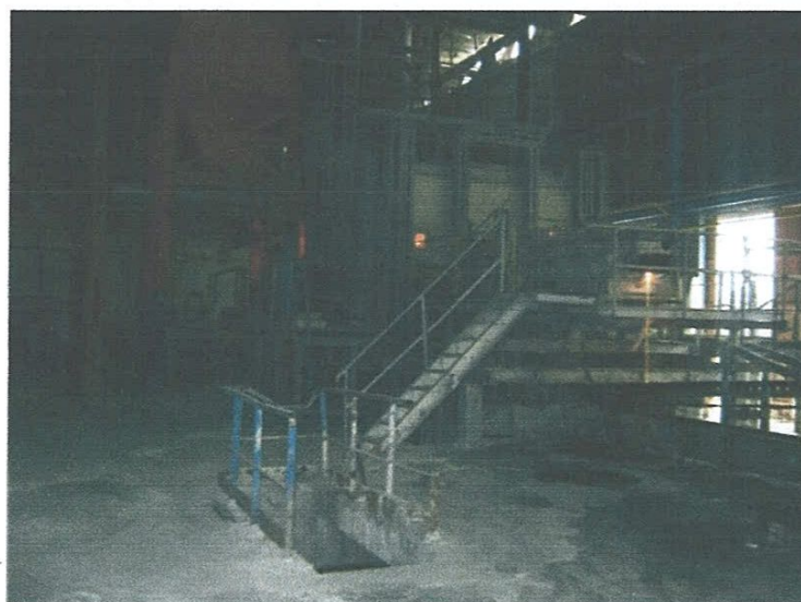
Figure 20 : Le four à récupérateur (AFRICAVER)
