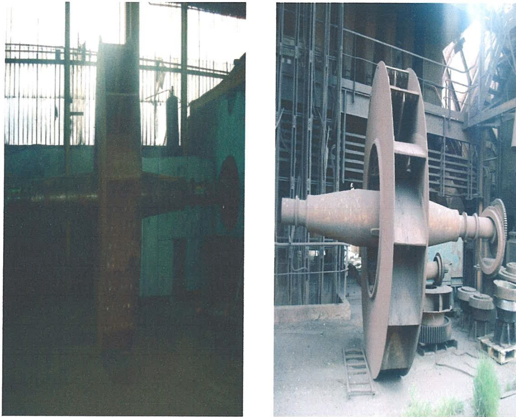
Fig. 2.1: Ventilateur du dé poussiérage cuisson; Complexe sidérurgique El hadjar
