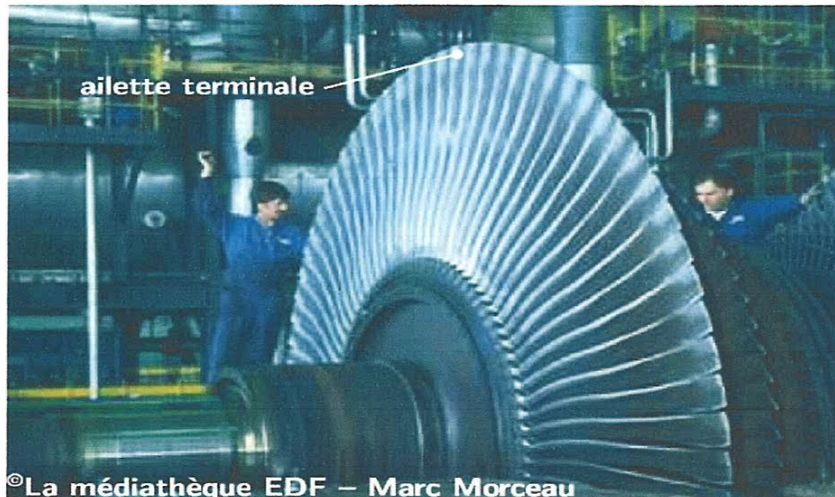
Fig. 1.5: Rotor de la centrale thermique classique de Porcheville (Yvelines)
