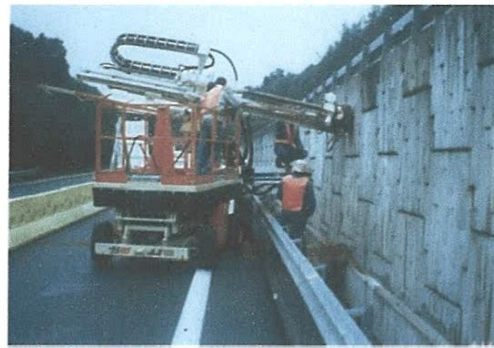
Figure 30 Photos du renforcement des murs soutènement affectés par clouage des écailles.
