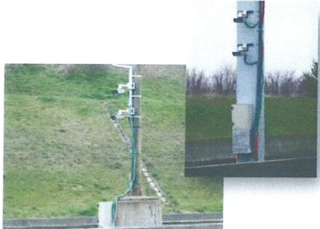
Figure 2.6 Lecteurs de plaque d'immatriculation installée sur portique (à droite) et mât temporaire (à gauche), à raison d'un lecteur par voie.
