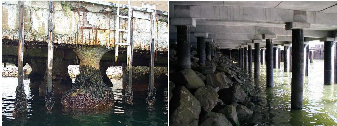
Figure I.9. Dégradation des ouvrages en environnement maritime (sous à l'attaque sulfatique)
