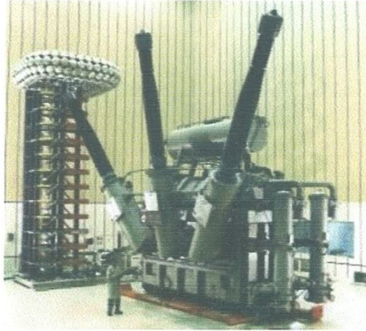
Figure I.2 : Transformateur de puissance
