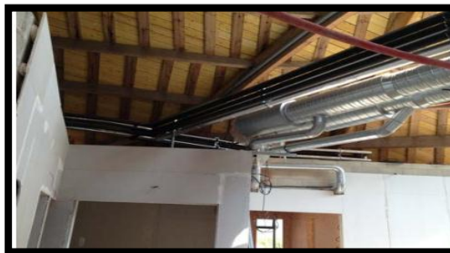
Figure 118 : système de ventilation à double flux, source ; http://docplayer.fr/storage/61/45885875/1546733259/HyHpxYy_WJXy7QwIJJOWDA/45885875.pdf
