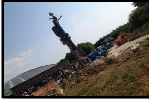
Figure 119 : l'installation d'une pompe à chaleur réversible eau-eau par capteur pour la géothermie, source : http://docplayer.fr/storage/61/45885875/1546733259/HyHpxYy_WJXy7QwIJJOWDA/45885875.pdf
