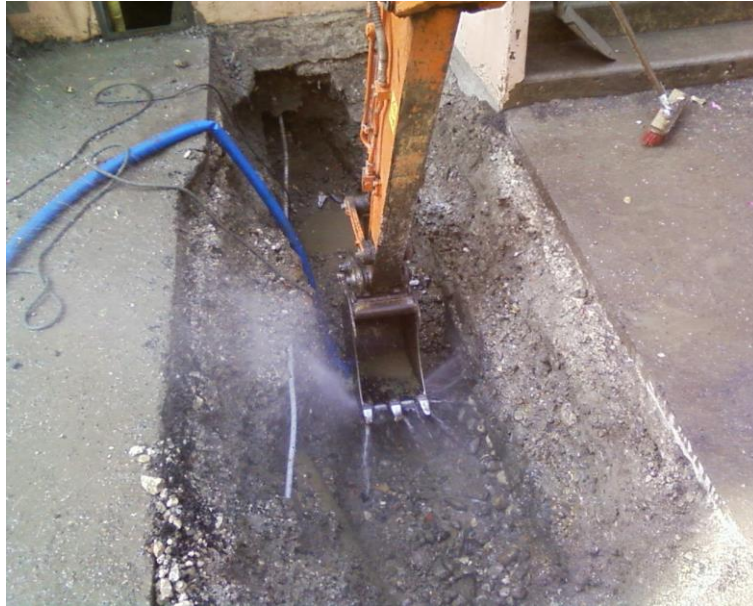
Photo 1.7 : les pertes d'eau dans un réseau d'AEP
