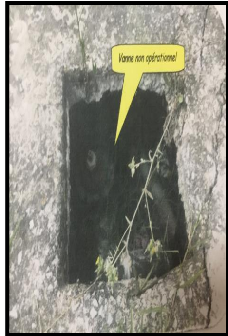
Figure 7 : Vanne non opérationnelle
