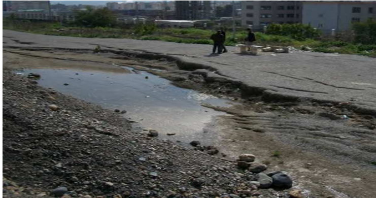
Figure 1.3a : Affaissement du terrain et stagnation des eaux
