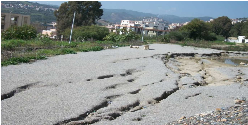
Figure 1.1 : Fissures, tassements sur la plateforme du stade.
