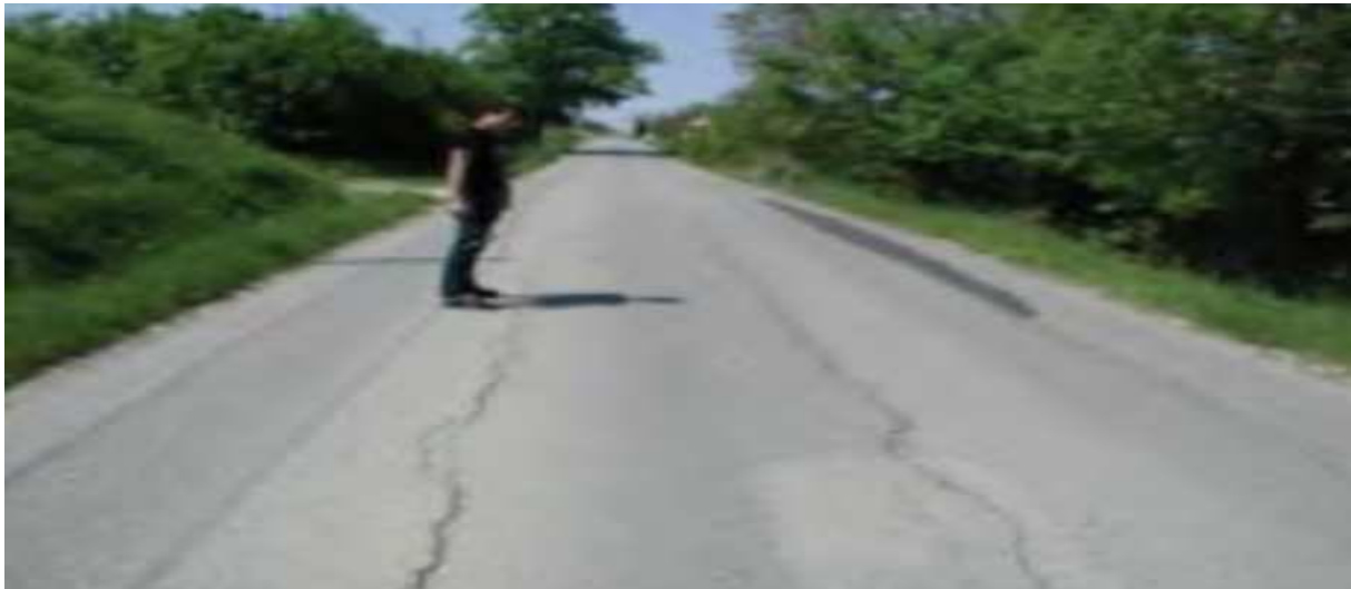
Figure 1. 4 : Fissuration longitudinale de routes due au retrait et gonflement des sols.
