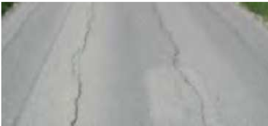
Figure 1.15 : phénomène de gonflements de sol sur la route.
