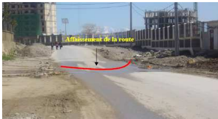
Figure 1.3b : Affaissement et bombement de la chaussée
