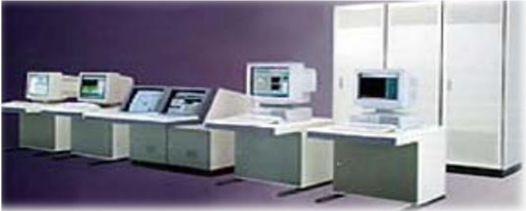
Figure 3.6. Vue de la salle de contrôle (stations HIS)
