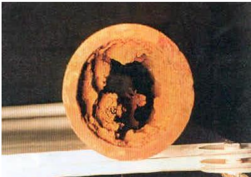
Figure 1.5: Conduite de diamètre 80 mm ayant subi des dépôts ferriques de corrosion interne
