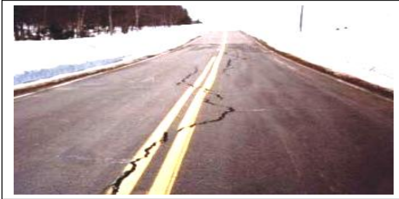
Fig.III.11:Fissures de gel
