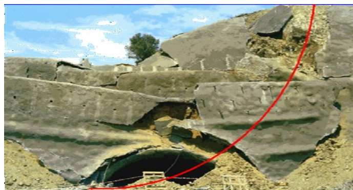
Figure.3.2 Tunnel de Patra après l'effondrement (Grèce, août 1998)
