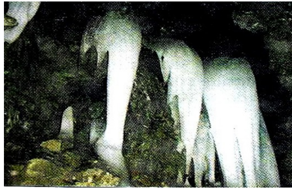
Figure 3.4 Arrivée d'eau gelée dans le tunnel de Galibier
