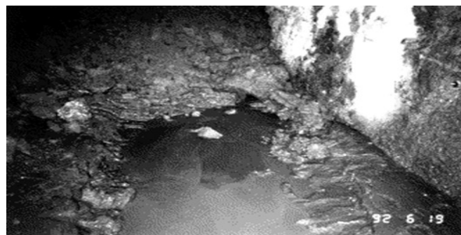
Figure.3.5 Inondation du tunnel de Wushantou, Japon 1992
