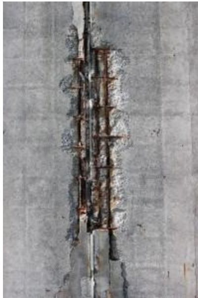
Figure IV.1 carbonatation du béton
