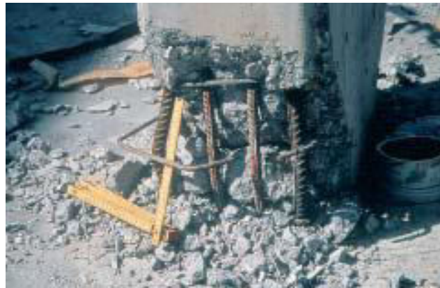
Figure VI.6 : Rupture des ancrages des étriers, dont les crochets n'avaient qu'un angle de 90^\circ (Izmit, Turquie, 1999).
