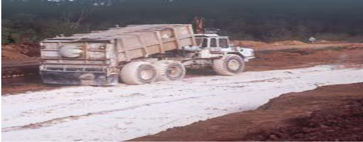
Fig III-5 : Epandage de liant hydraulique revue de l'école des ponts et chaussées Paris 2010
