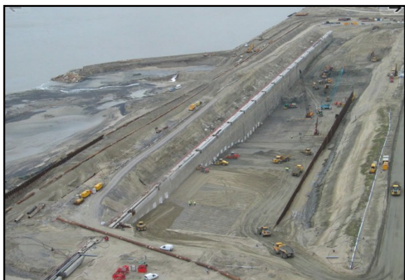
(a) Vue d'ensemble du quai lors du terrassement, après la mise en place de la paroi moulée et du rideau de palplanches.
