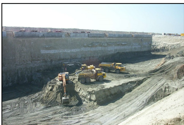
(c) Terrassement derrière la paroi moulée pour la mise en place du premier lit de tirants d'ancrage.
