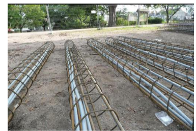
Figure 07 : pieu échangeur de chaleur
