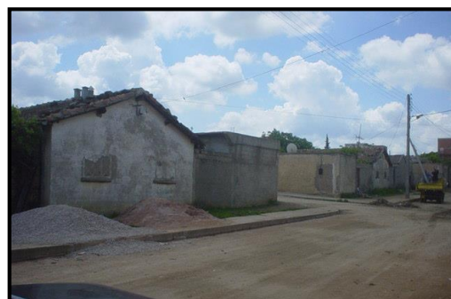
Figure 53: Etat dégradé des anciennes constructions
