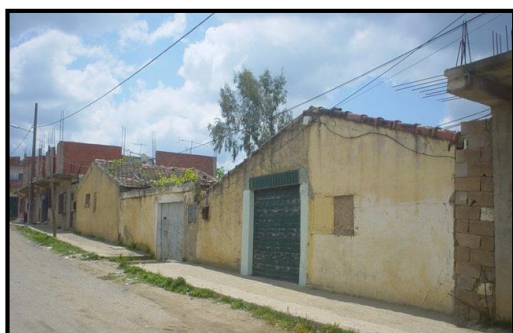
Figure 54: Etat moyen à dégradé
