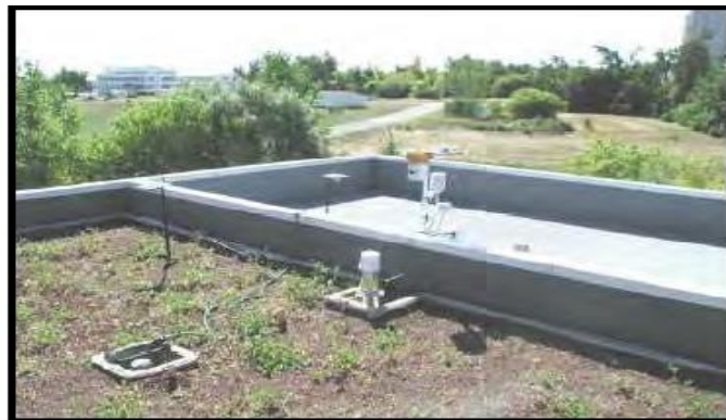
Figure 20 séparation de deux toit : le toit vert (à gauche) et le toit de référence (à droite)
