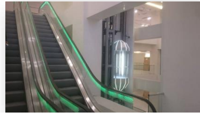
Figure 91 : circulation verticale (escaliers mécanique, auteur)
