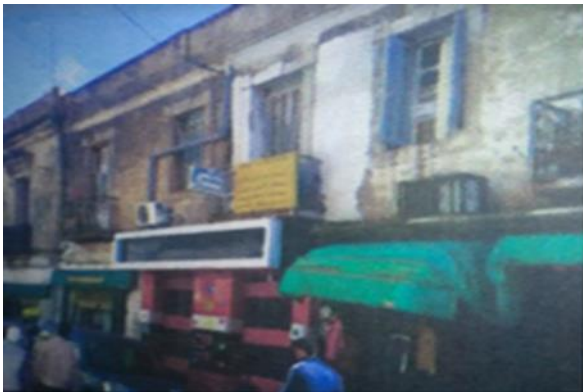
Bâti en mauvaise état
