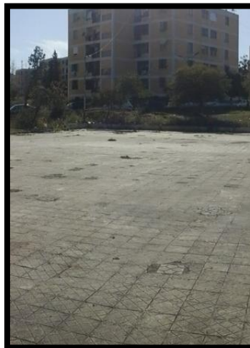
Figure 4.11 : Photographies montrant l'état de sol Au niveau de la place
