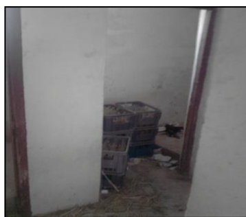
Photo03 : salle de soin à Boumendjel.
