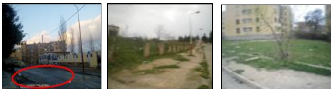
Photo 18 : Etat de trottoirs dans le quartier Chaabani.
