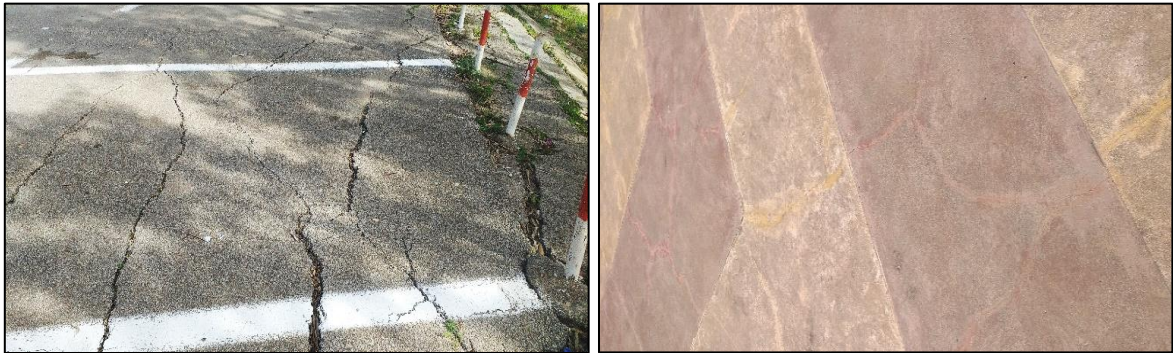
Figure IX.27: photos montrant l'état de la chaussée. Source: Auteure 2025
