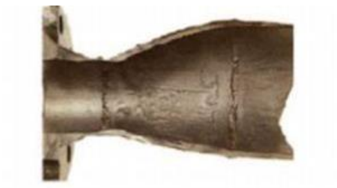
Figure I.7 : Corrosion-érosion dans une zone turbulente ([Benard.J, et al ; 1969]).
