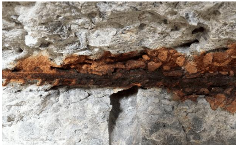
Figure I.3 : Béton armé en corrosion [29]
