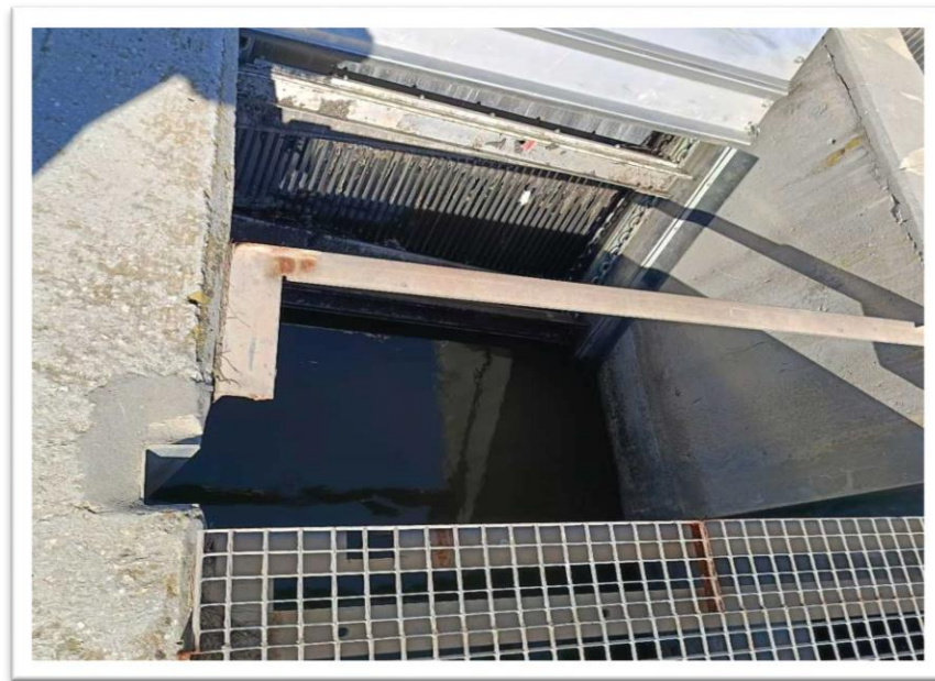
Figure 05: Dégrillage (Photo personnelle, 2025).
