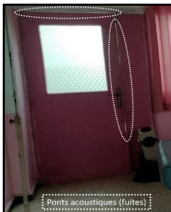
Figure 187 : les problèmes d'étanchéité de la porte de la chambre des patients ; Source : Auteurs, 2025
