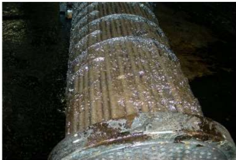
Figure IV. 4: Exemple d'un faisceau de tubes d'un échangeur encrassé.
