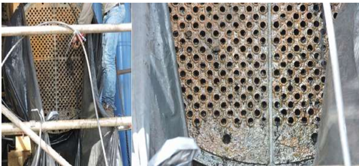
Figure III. 1: Vue de l'encrassement d'un faisceau de l'échangeur 100-E-115 A/B.
